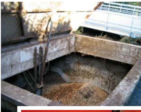
Silo d'alimentation de la chaudière
